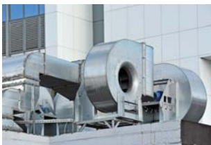
暖通风机 HVAC
